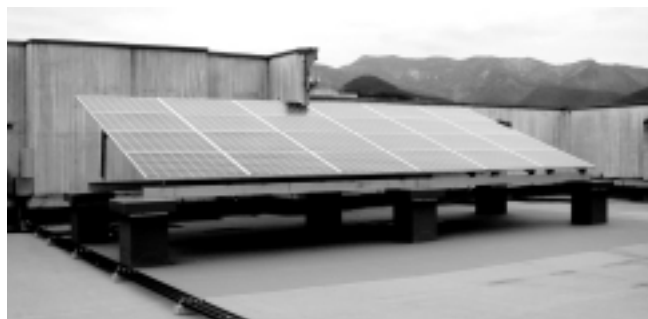
甲府商工会議所屋上太陽光発電システム
